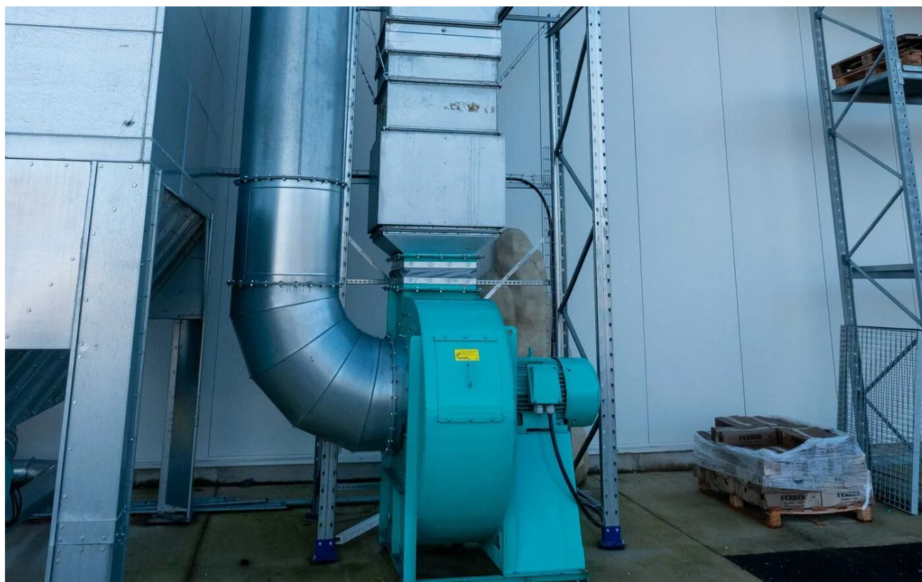
Une installation d'aspiration réelle : réseau de gaines, dépoussiéreur et ventilateur centrifuge, autant d'éléments que le diagnostic mesure.
