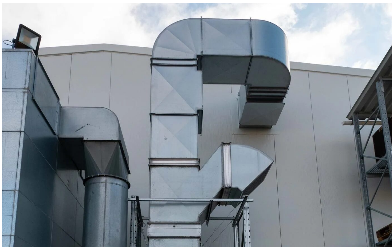
Un réseau d'aspiration : chaque gaine, coude et changement de section pèse sur le débit et la pression.
